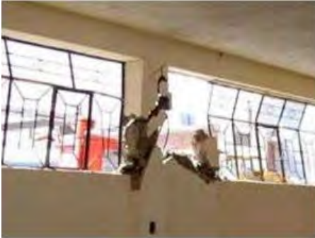
Fallas en columnas "Columna corta"
