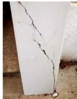
Fallas en columnas por cortante
