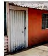
Construcción de elementos adicionales fuera de norma
