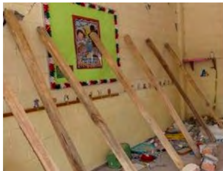
Desplomes y agrietamientos en muros de mampostería
