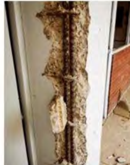
Fallas en columnas (desprendimiento de área de recubrimiento)
