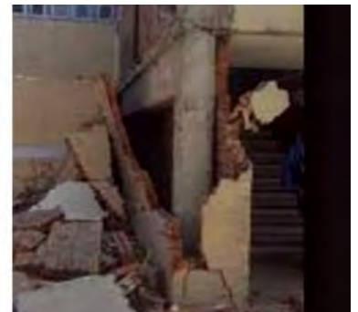
Desprendimiento de acabados "Muros cabeceros"
