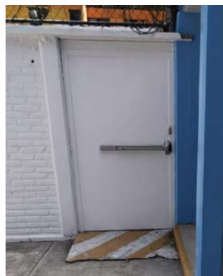
Salida de emergencia
