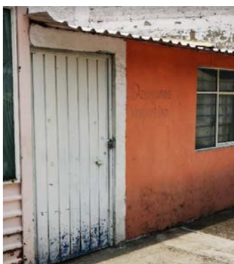
Construcción de elementos adicionales fuera de norma y sin autorización
