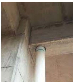
Perforación de trabes o columnas
