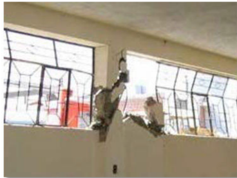
FALLAS EN COLUMNAS "COLUMNA CORTA"
