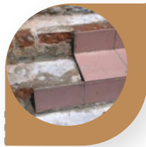
Escaleras en mal estado
